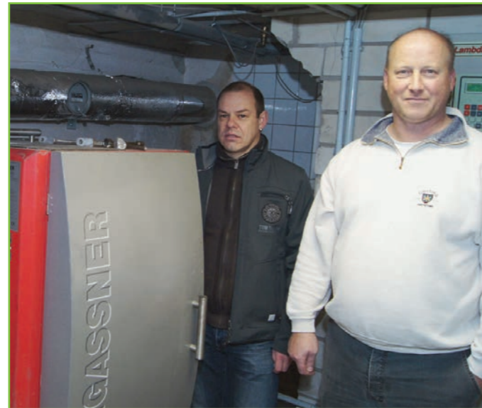
Wärme durch Holzhackschnitzelheizung. Fleischermeister Franz Többen (rechts) ist von dem Energieeinsparpotential der Anlage überzeugt und demonstrierte sie Wilfried Gravel von der EEA-EL. Foto: Keuper
